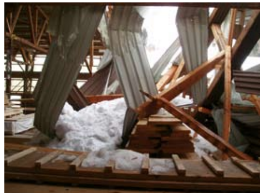
Abbildung 4: Schneedruck verursacht Hallendacheinsturz, Waldstatt 2006. (Quelle: Thomas Egli)
