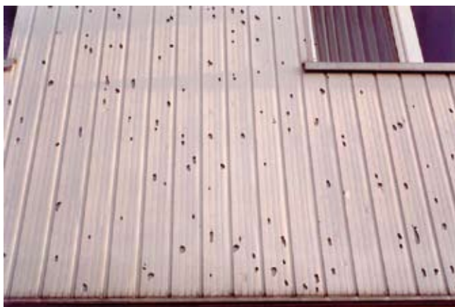
Abbildung 3: Hagelschaden an Kunststofffassade, Wetzikon 2004. (Quelle: Thomas Egli)
